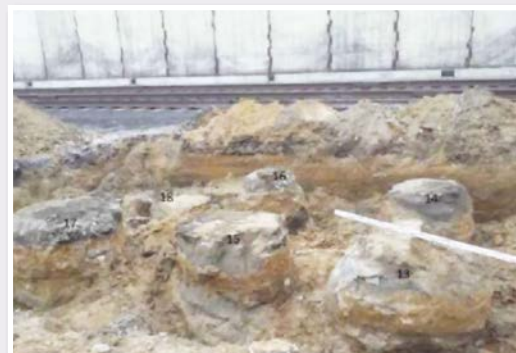
Рис. 4. Опытный участок №2. Вид голов грунтоцементных колонн, выполненных по технологии Jet-2 (диаметр 1,1–1,3 м)
